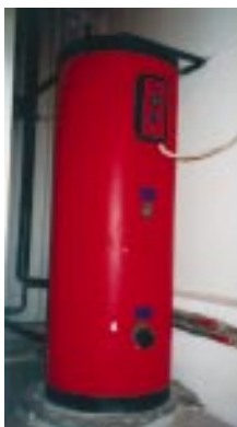
Κεντρικό μπόιλερ ζεστού νερού με θερμομονωτικό κάλυμμα.
