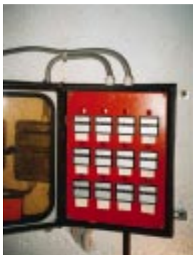
Ωρομετρητές εγκατάστασης θέρμανσης, σε πολυκατοικίες.
